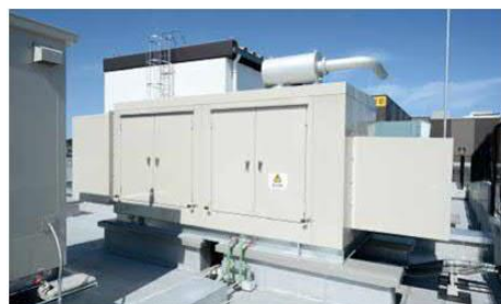
非常用発電機
