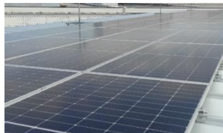
太陽光発電設備
