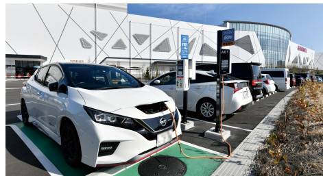
EV充電器（イオンモール新利府南館）
