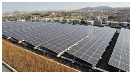
太陽光発電システムの導入を積極的に進めています。現在は中国の3モールも含めて全27モールで設置しており、館内で使用する電力の一部をまかなっています。
