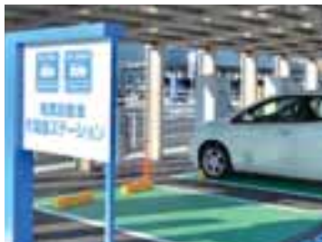
EV充電ステーション
