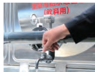
緊急用の給水取り出し口
