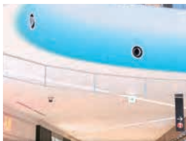
飛散しにくい透明不燃シートを採用した防煙垂壁 (イオンモール徳島)
