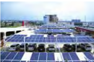
▲駐車場、バイク駐輪場屋根に合計約320kWの太陽電池モジュールを設置。年間約270トンのCO 2 削減をめざします。
