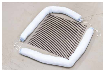
流出を防止する専用の油吸収剤を常備
