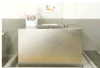
ごみ庫に設けられた防油堤
