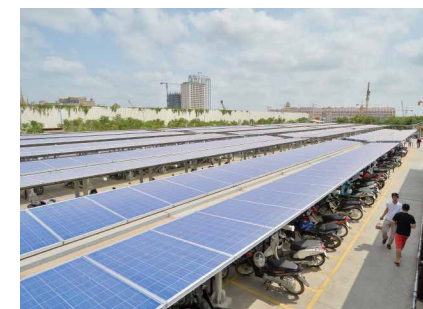
バイク置き場の屋根とテラスアベニューの歩道に 合計1,680㎡の太陽光モジュールを設置
