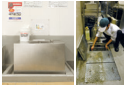
ごみ庫内に設けられた防油堤 グリストラップ清掃
