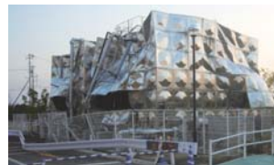
敷地内に設置された受水槽も大きく歪んで使用不能になりました。
