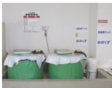
廃油も専用のタンクに。吸着マットを使い、洩れがないようにしています。
