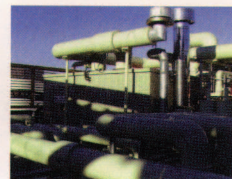
排ガス排熱投入型吸収冷水機 (大和SC)
