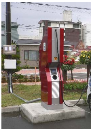
急速充電ステーション
