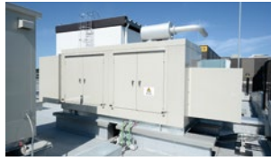
引进应急发电机，确保防灾中心和事务所等主要管理室在停电期间有电可用。
