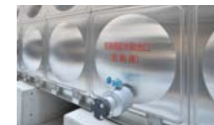
抗震型储水槽上设有紧急供水口，可在停水停电状态下确保居民有水可饮。
