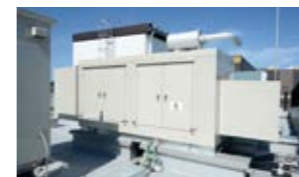
引进应急发电机，确保防灾中心和事务所等主要管理室在停电期间有电可用。
